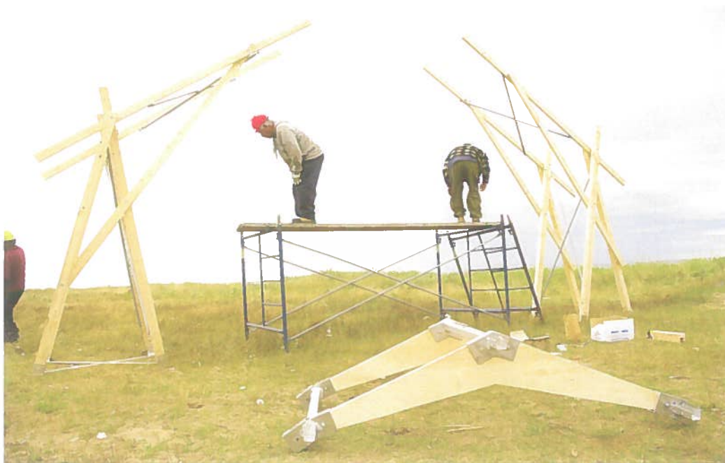
Montage de l'échafaudage + module de faîte en avant plan. Pessamit. Juillet 2012. Source : De l'auteur.
