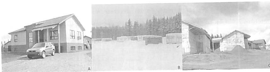
Figure 81 : Nouveau modèle standard, Ujé-Bougoumou A. Nouveau modèle standard ; B. fondations des habitations du nouveau développement janvier 2009 ; C. Avancement des travaux du nouveau développement en juin 2009 Source : Caroline Morneau, janvier et juillet 2009
